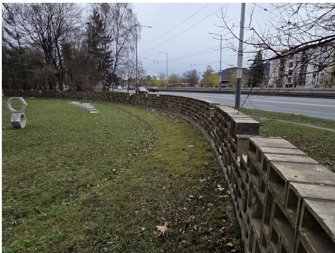
Foto. č. 2 Lokálne poškodenia kameninových tvárnic
