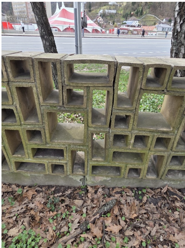
Foto. č. 1 Priebežná zvislá trhlina prechádzajúca aj do základu
