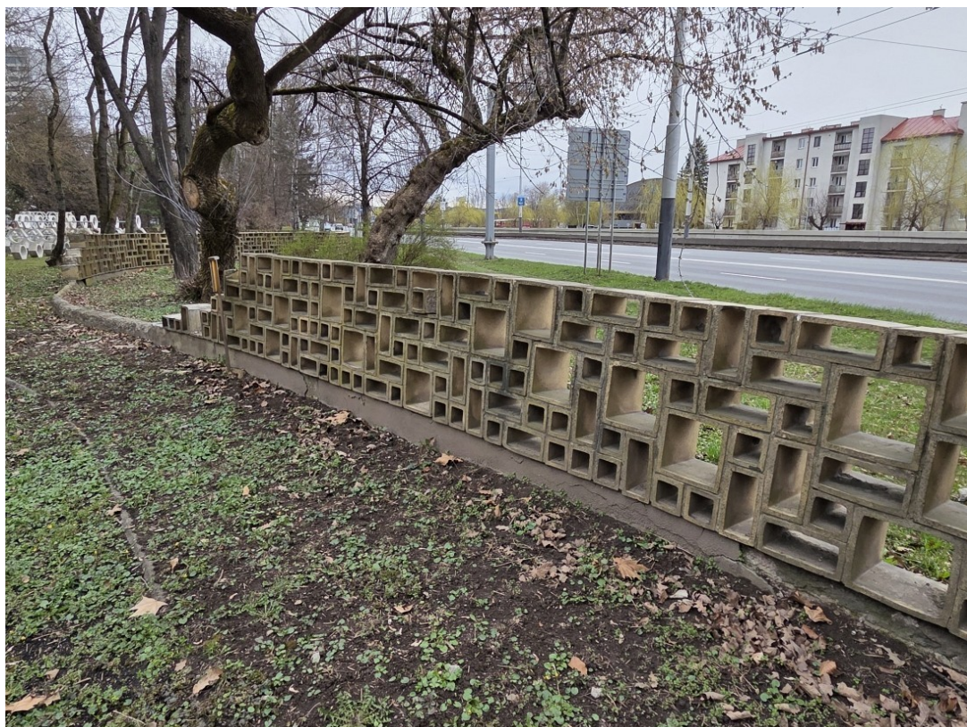
Foto. č. 4 – Naklonený keramický múr a časť už zrúteného keramického múru.
