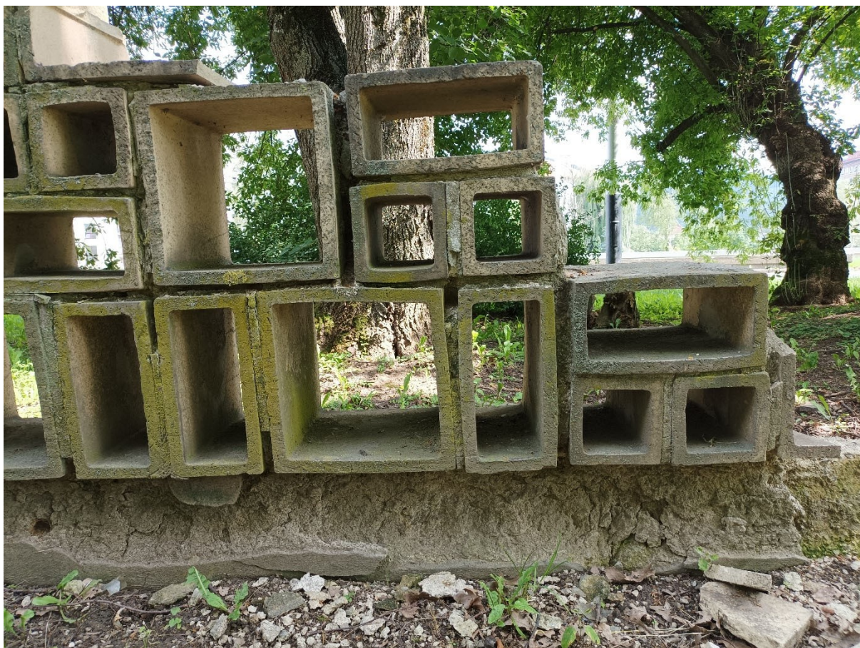
Nevhodný materiál na podmurovku a základ múru spôsobil ich rozpad a následne deštrukciu samotného múru.
