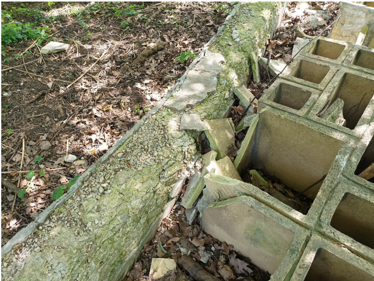
Základ sa drolí a spôsobuje pád múru a rozlámanie rebrových tvárnic.
