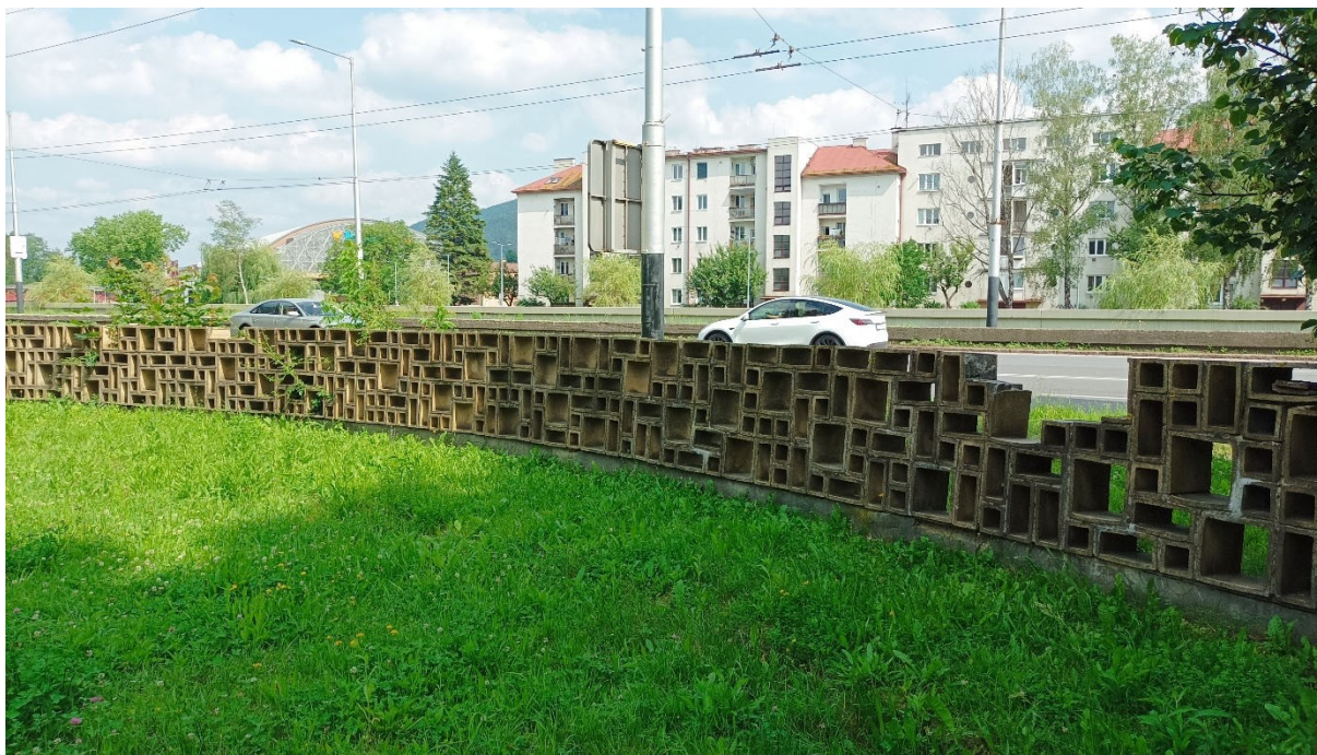
Kameninový plot so zvlneným pôdorysom oddeľuje priestor parku od cesty. Jednotlivé tvárnice sa ale rozpadajú, uvoľňujú a vypadávajú.
